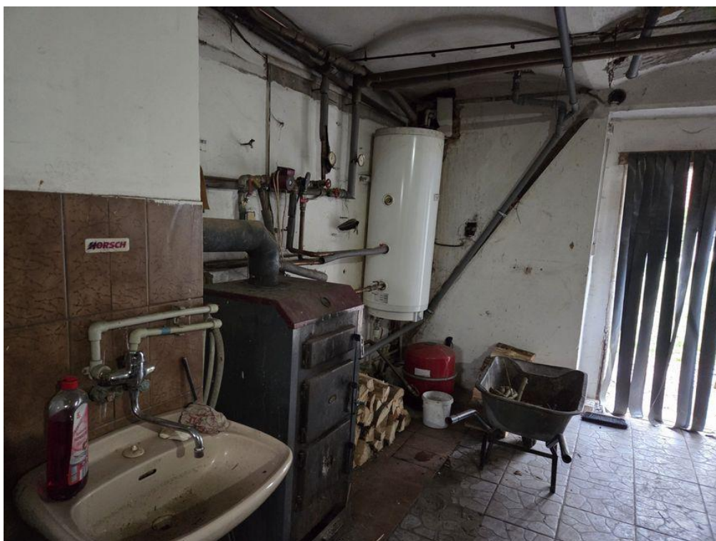
1. NP - kotelna + kotel na tuhá paliva + kombinovaný bojler
