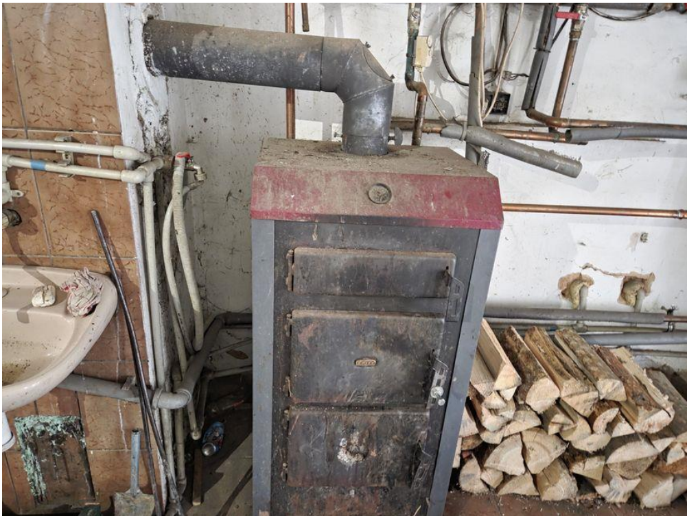
1. NP - kotelna + kotel na tuhá paliva
